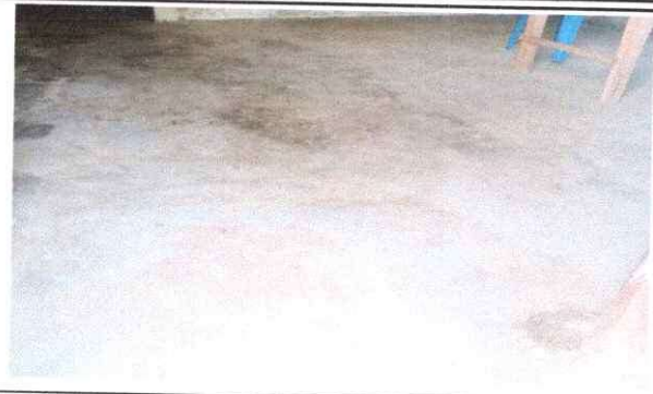
Foto 1: El piso de la escuela esta en mal estado, por lo que es necesario cambiar
