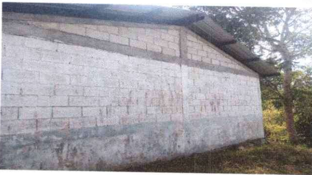
Foto 3: El repello de las paredes se deterioro, y es necesario volver a repellar y pintar.
