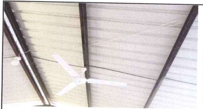
Foto 4: El cableado electrico esta mal organizado y algunos colgando, por lo que hay necesidad de reestructurarlo.
