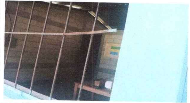
Foto 2: Las ventanas de las aulas se estan deteriorando, por lo que es indispensable cambiarlas.
